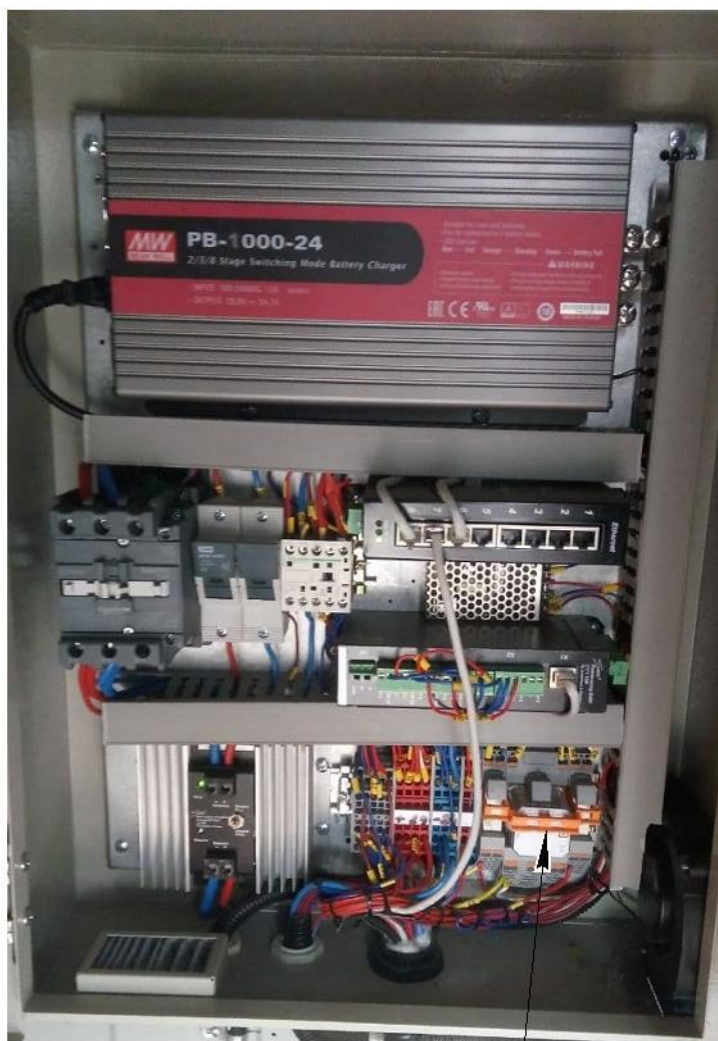
Индикация электропитания реле компрессора
