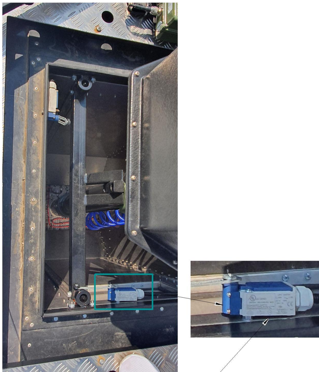
Датчик электропитания мачты
